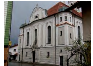
5.000,- € steuerte der Landkreis zur Renovierung der Außenfassade der Pfarrkirche St. Andreas in Nesselwang bei.
