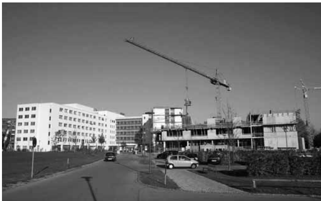
Am Klinikum Kaufbeuren entsteht derzeit das Multifunktionsgebäude. Die Inbetriebnahme erfolgt voraussichtlich Mitte 2008.
